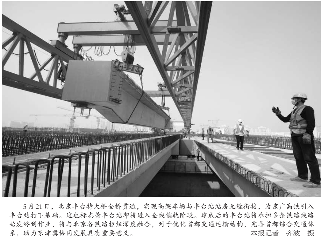
5月21日,北京丰台特大桥全桥贯通,实现高架车场与丰台站站房无缝衔接,为京广高铁引入丰台站打下基础。这也标志着丰台站即将进入全线铺轨阶段。建成后的丰台站将承担多条铁路线路始发终到作业,将与北京各铁路枢纽深度融合,对于优化首都交通运输结构,完善首都综合交通体系,助力京津冀协同发展具有重要意义。本报记者 齐波 摄
