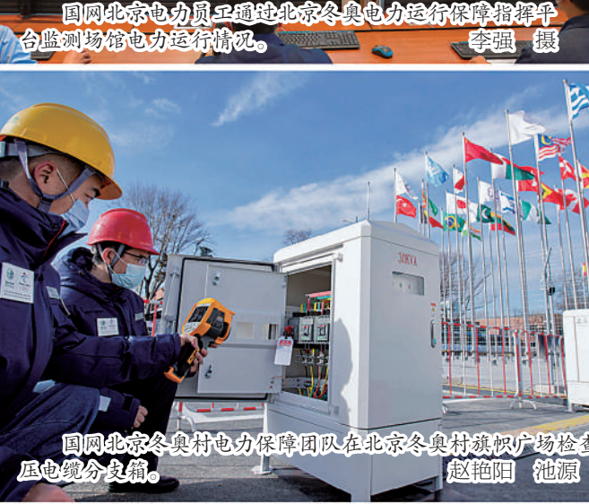
国网北京冬奥村电力保障团队在北京冬奥村旗杆广场检查低压电缆分箱。赵艳阳 池源 摄
