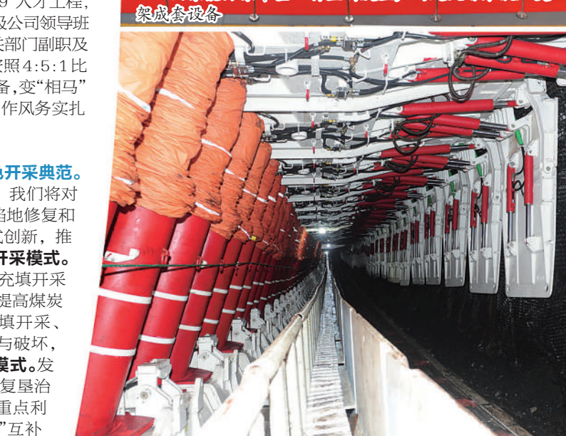
山东能源东平集团付村煤矿智能化大采综采工作面
