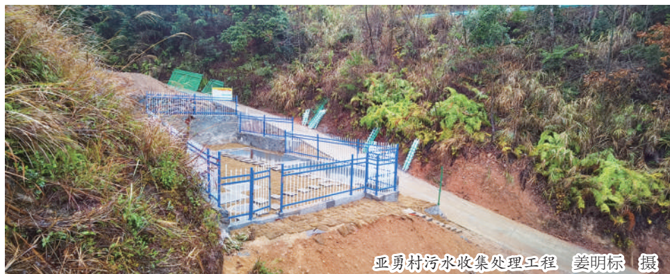
亚勇村污水收集处理工程 姜明标 摄
