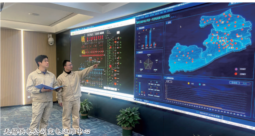
无锡供电公司变电运维中心
