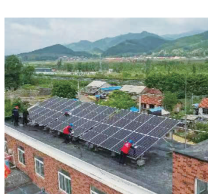
6月2日,国家电网辽宁电力(本溪桓仁)雷锋共产党员服务队来到桓仁县五道河村对光伏发电项目进行调试。(魏强)
