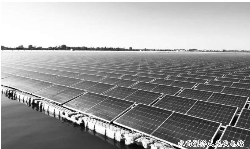
水面漂浮式光伏电站
