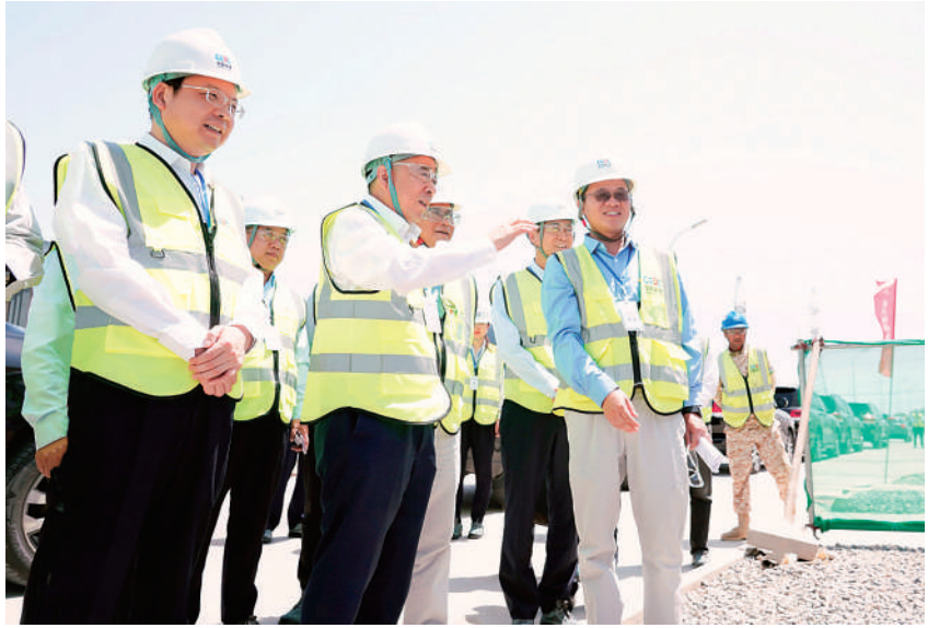
宋海良(前排中)在乌兹别克斯坦锡尔河1500兆瓦天然气电站项目调研
